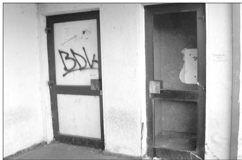
Der ehemalige Haupteingangsbereich des alten Jöllenbecker Postgebäudes sieht in einem äußerst mitgenommenen Zustand aus.
